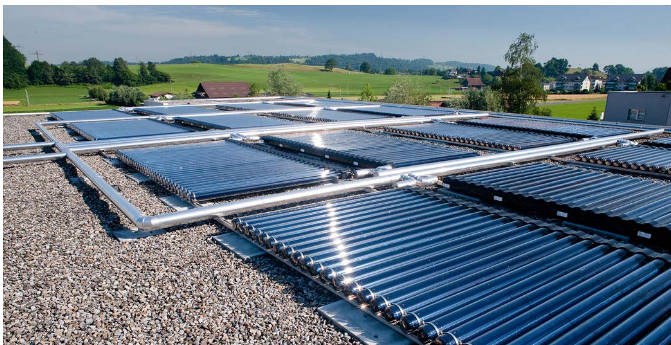
Thermische Solaranlage auf dem Dach der Kerzenfabrik Root.
