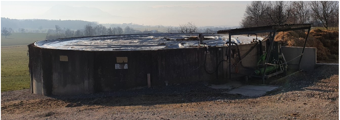
Abb. 1: Teilschwimmende Abdeckung, Schwimmfolie. Bild: Dienststelle uwe.
